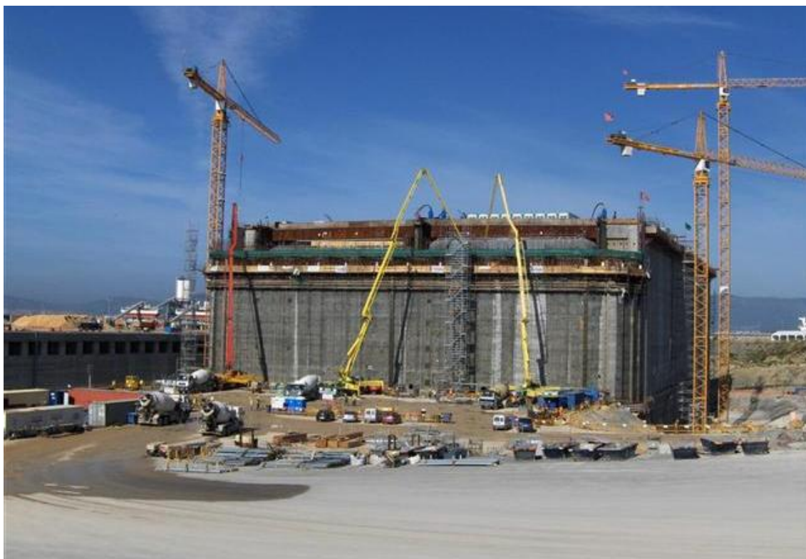
Impianto di rigassificazione dell'Alto Adriatico - Giugno 2007 - Viene completata la struttura principale in cemento armato (GBS)
